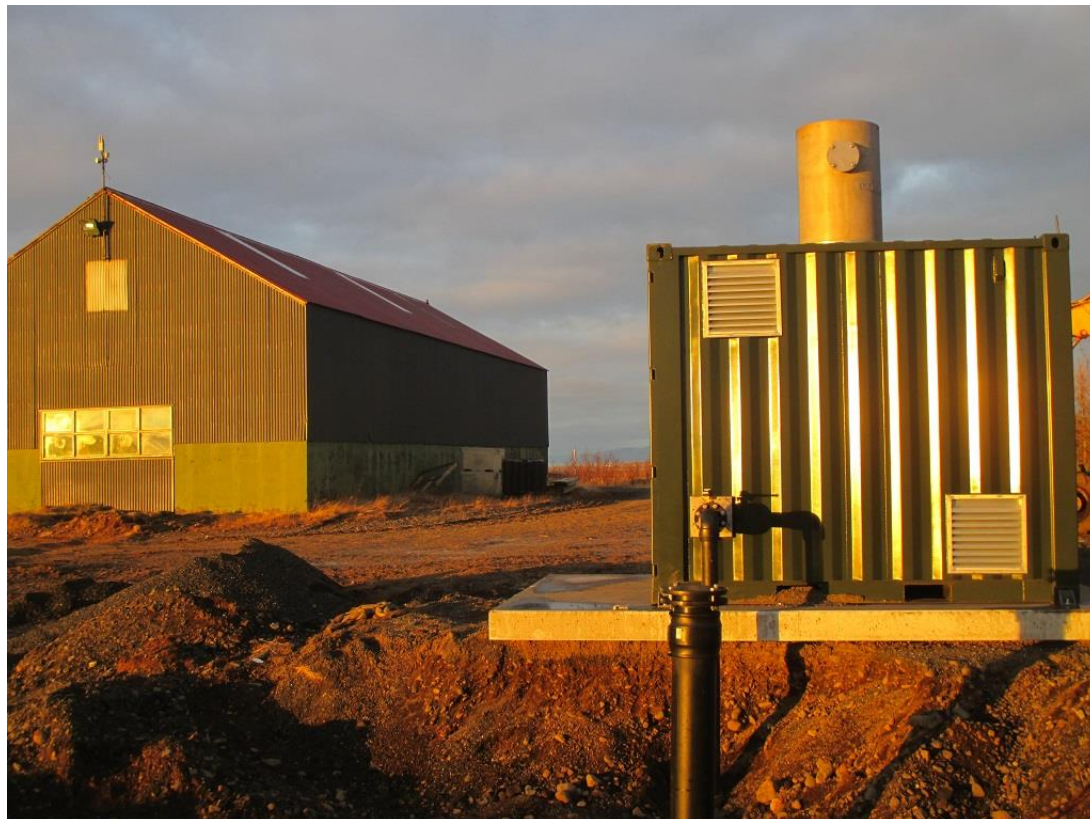
Mynd 2. Gasbrennslukyndill í Fíflholtum 26. nóvember 2018.
